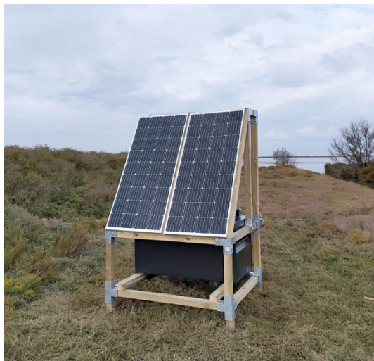
Figure 3 : Structure d'alimentation solaire pour les antennes RFID (© MRM)
